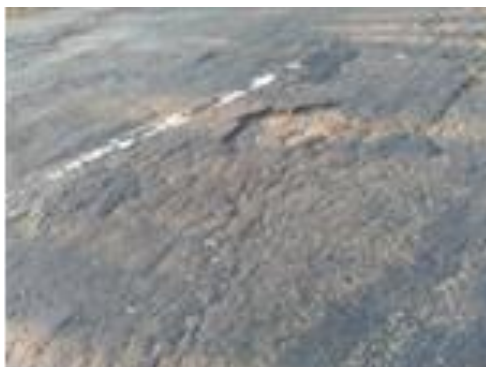
Gambar 1. Kerusakan Lubang Segmen 1
