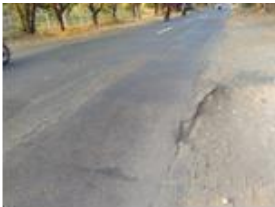
Gambar 4. Kerusakan Sungkur Segmen 4
