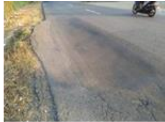
Gambar 2. Kerusakan Sungkur Segmen 2
