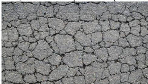
Gambar 3. Retak Susut Permukaan
